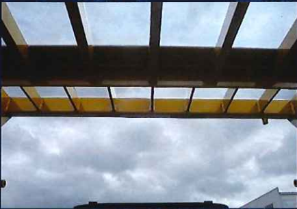
キャノピ天井にはポリカーボネート板を採用。上方視界を確保します。
